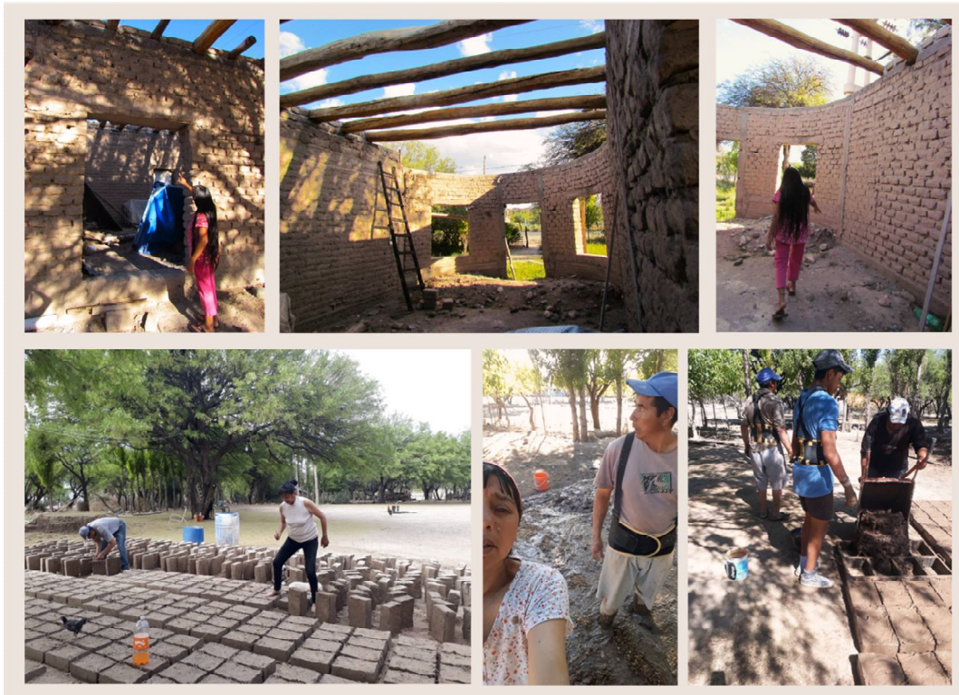
Figura Nº 3: Arriba: Celia muestra y explica el proyecto y la obra de la cocina de su casa. Abajo: se observa el trabajo junto a su familia en la cortada de adobes en su vivienda
